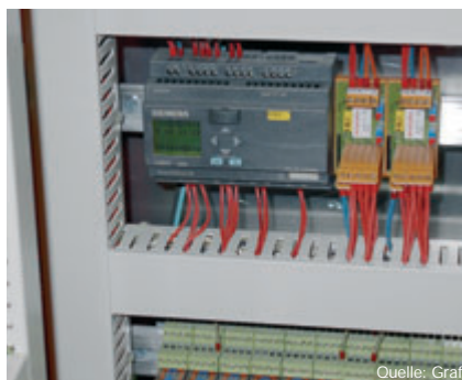
Bild 1 Mikrosteuerungen ersetzen aufwändige Relaischaltungen
